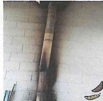
Foto 2: chimenea en mal estado
