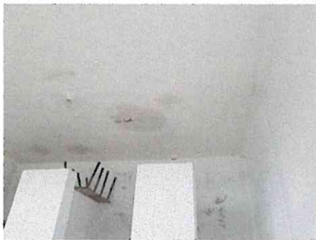
Foto 3: filtración de agua en los sanitarios
