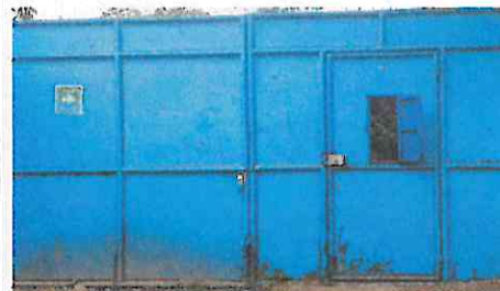
Foto 6: porton picado de la parte inferior
